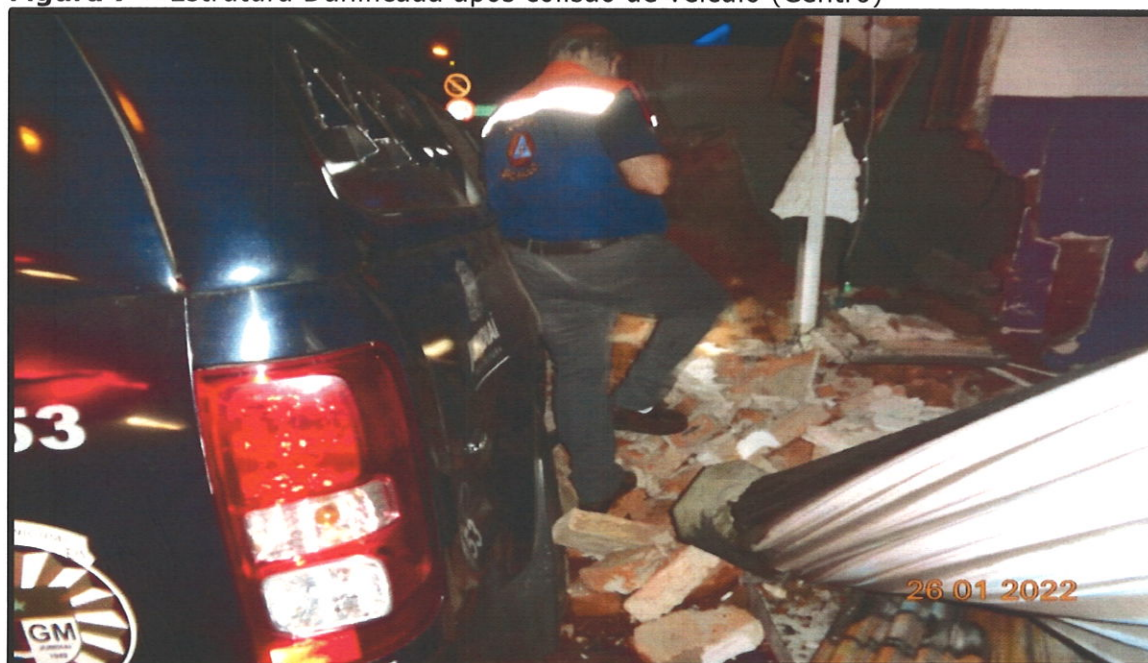
Figura 7 – Estrutura Danificada após colisão de veículo (Centro)
