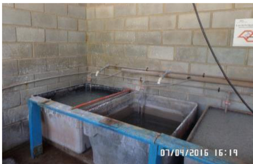
Figura 4.8 - Tanque para preparo de soluções a serem adicionadas no floculador decantador
