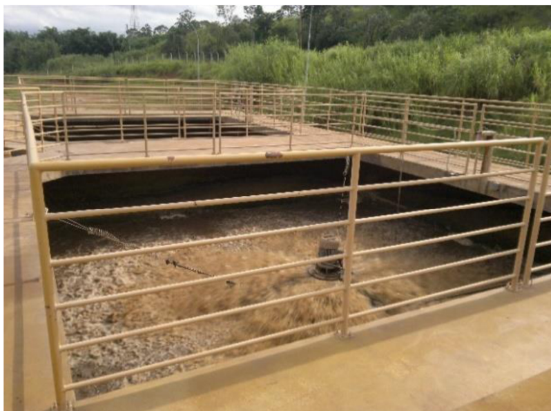
Figura 4.18 - Tanques de aeração da ETE Fernandes
