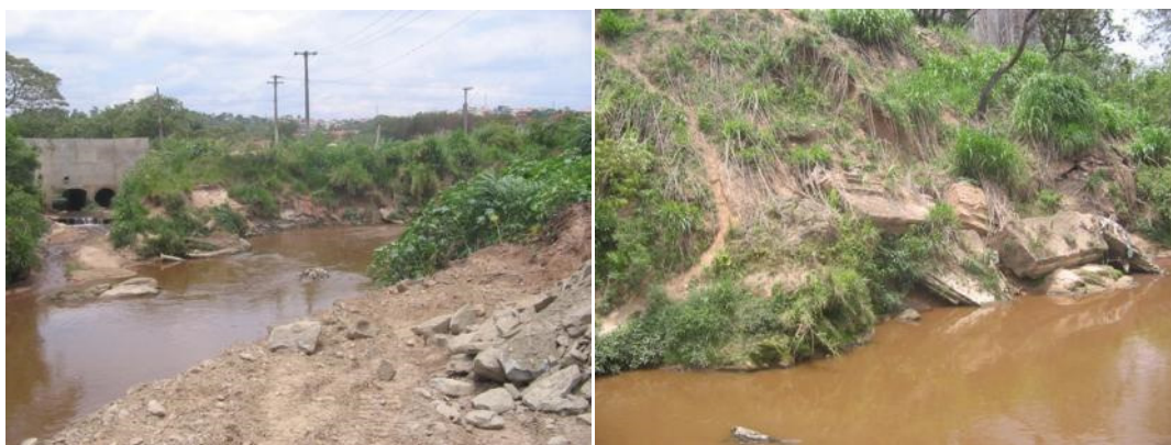
Figura 6.3 - Rio Jundiá – Presença de assoreamento, entulho e deslizamentos
