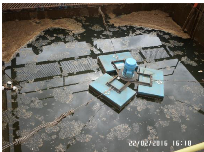
Figura 4.19 - Tanques de aeração da ETE Fernandes
