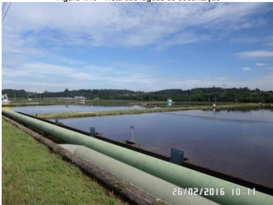
Figura 4.16 - Vista das lagoas de decantação
