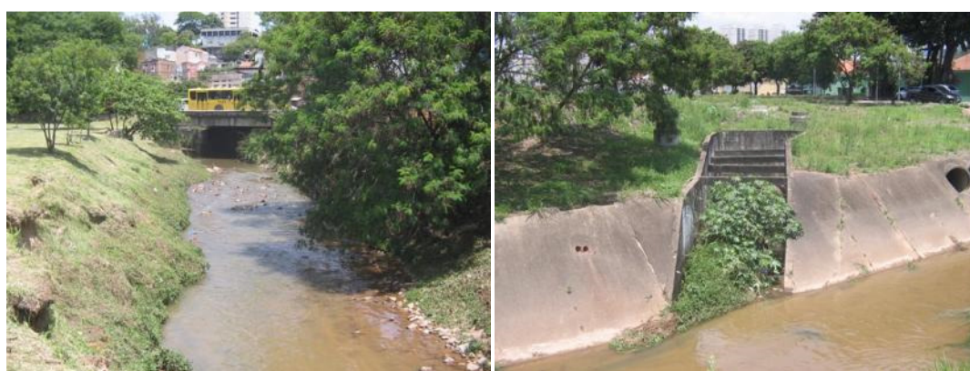
Figura 6.4 - Rio Guapeva – Presença de entulho e obstruções
