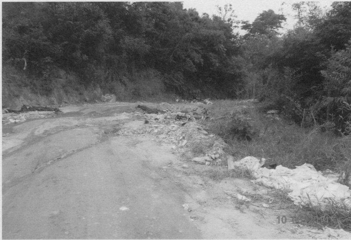
OUTRA VISTA DE ENTULHOS NA ESTRADA DA BOIADA
