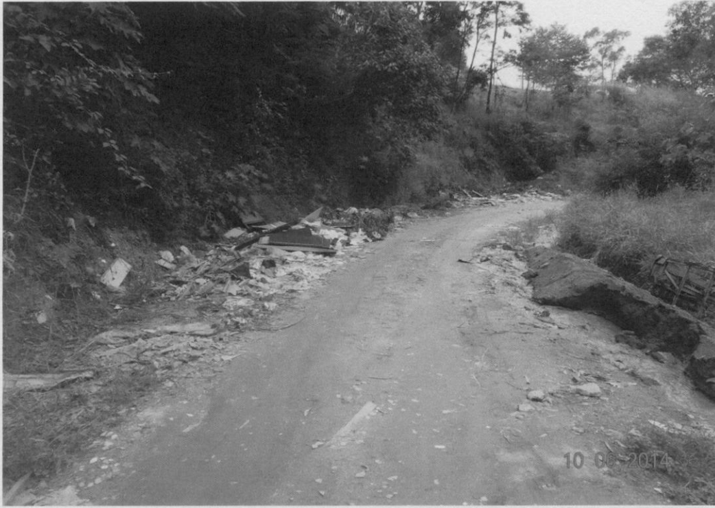
IMAGEM DA ESTRADA DA BOIADA, MOSTRANDO OS ENTULHOS
