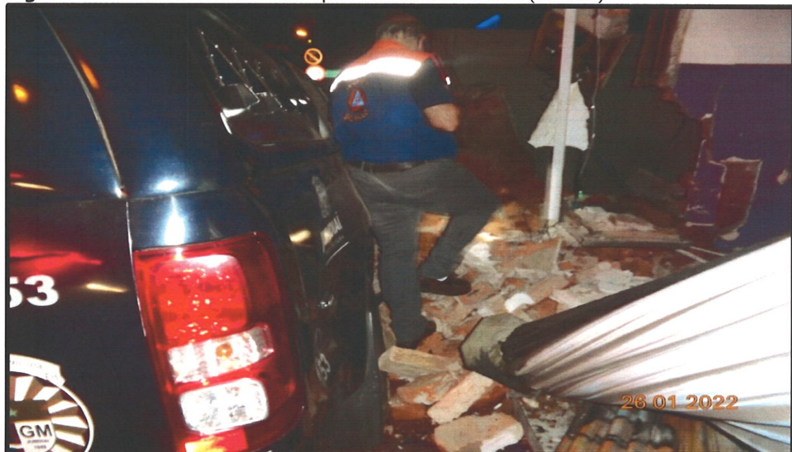
Figura 7 – Estrutura Danificada após colisão de veículo (Centro)
