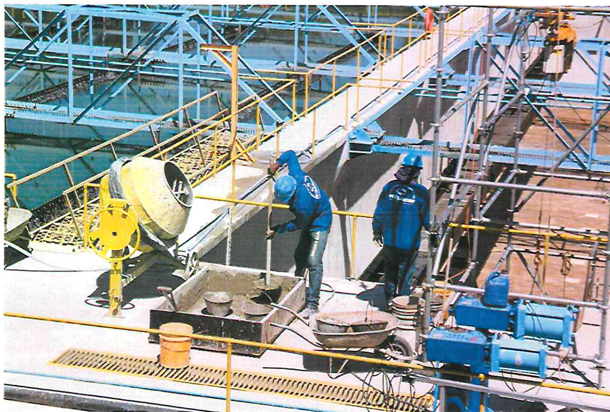
ETA terá a capacidade de tratamento ampliada de 1.800 para 2.400 litros por segundo
