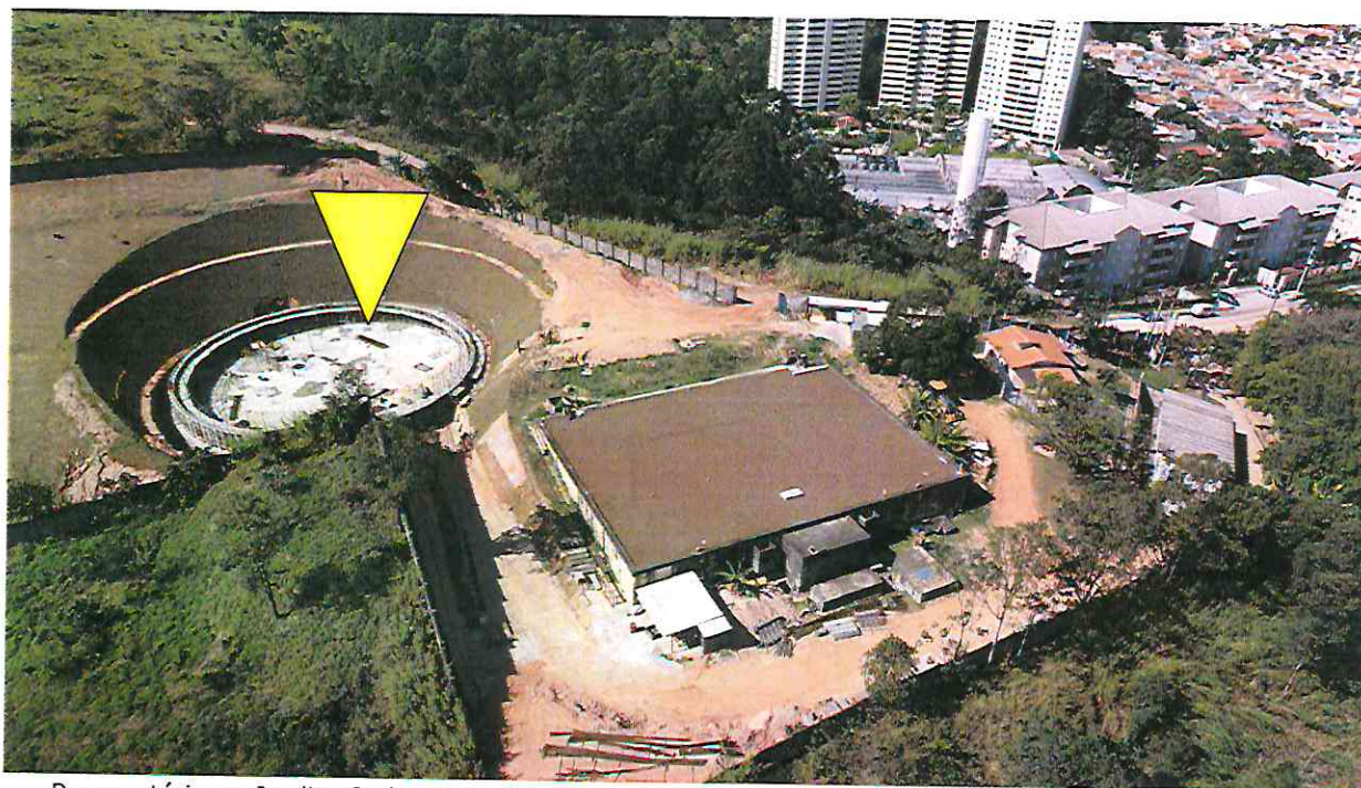
Reservatório no Jardim Carlos Gomes terá capacidade para armazenar 5 milhões de litros de água tratada
