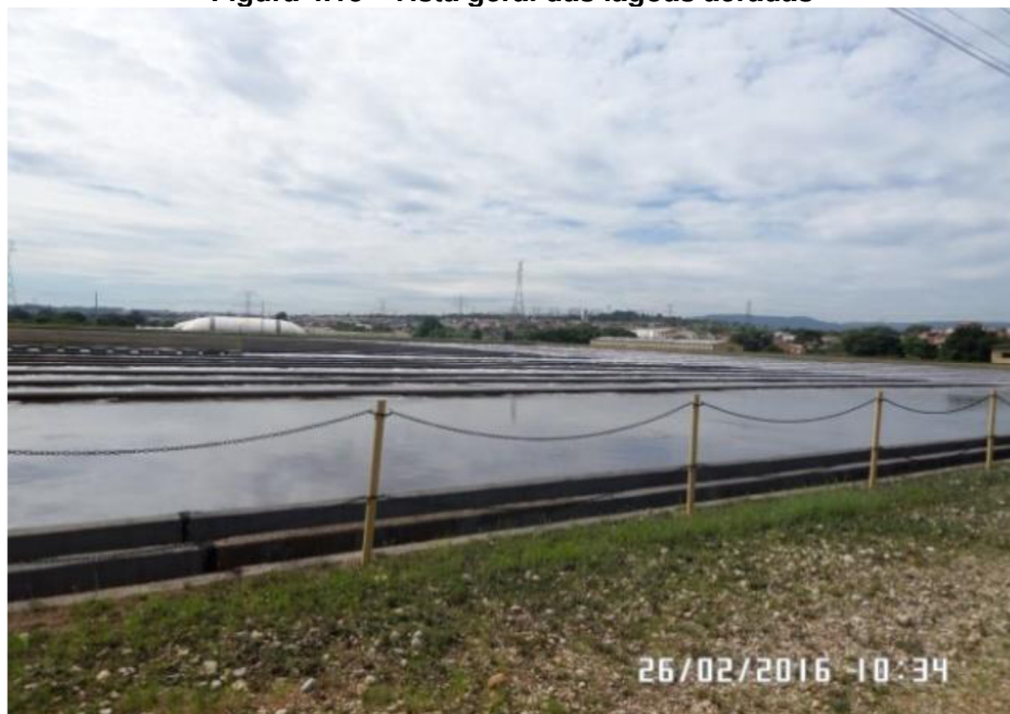
Figura 4.15 - Vista geral das lagoas aeradas
