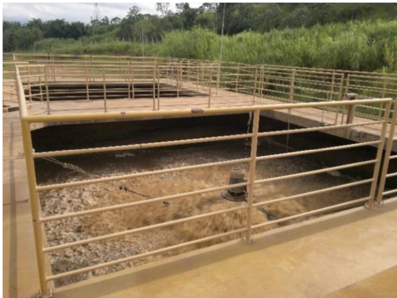
Figura 4.18 - Tanques de aeração da ETE Fernandes
