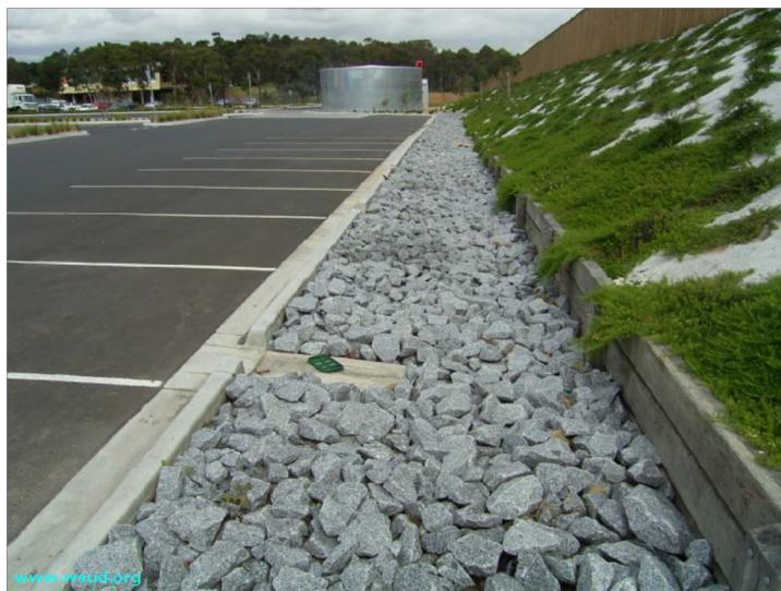
Figura 7.15 – Trincheira de infiltração
