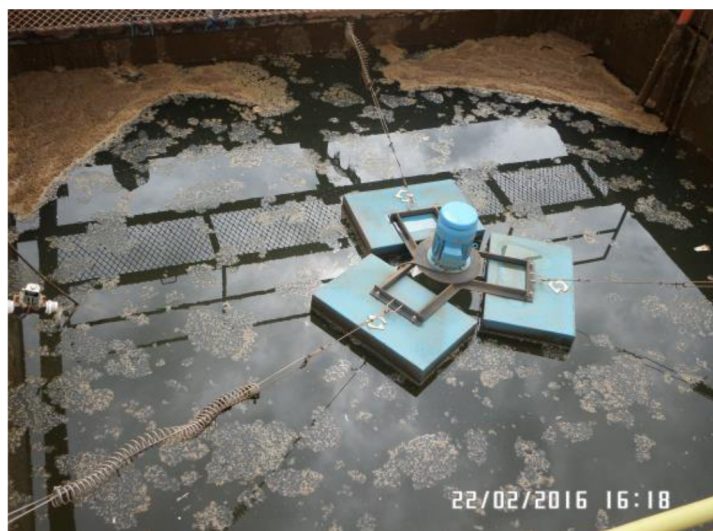
Figura 4.19 - Tanques de aeração da ETE Fernandes
