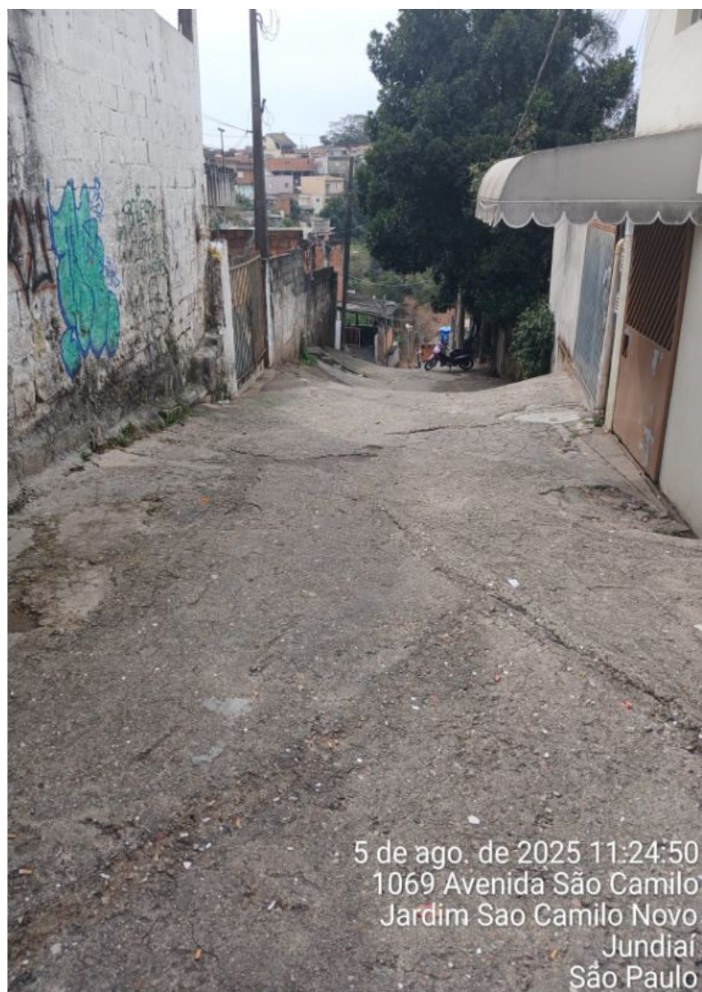
- Vial desnívelada e com buracos
