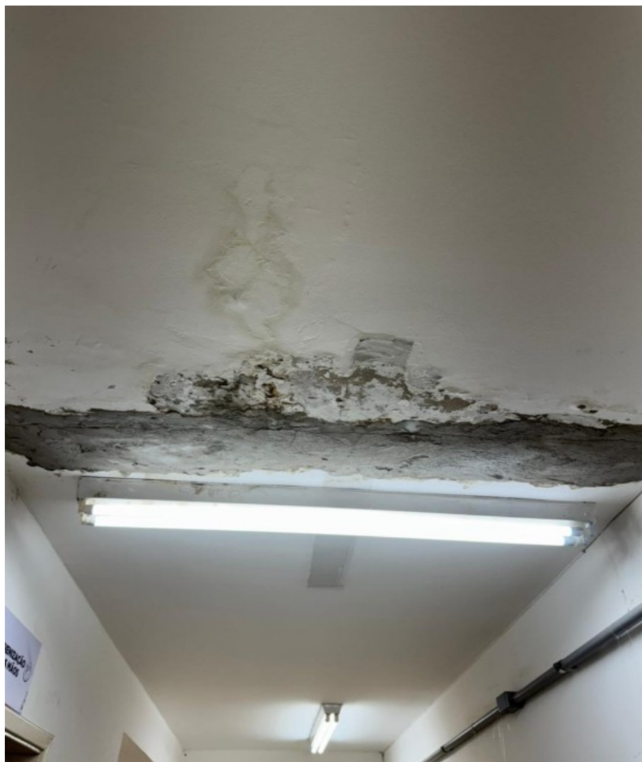
Recuperação urgente das infiltrações e juntas de dilatação
