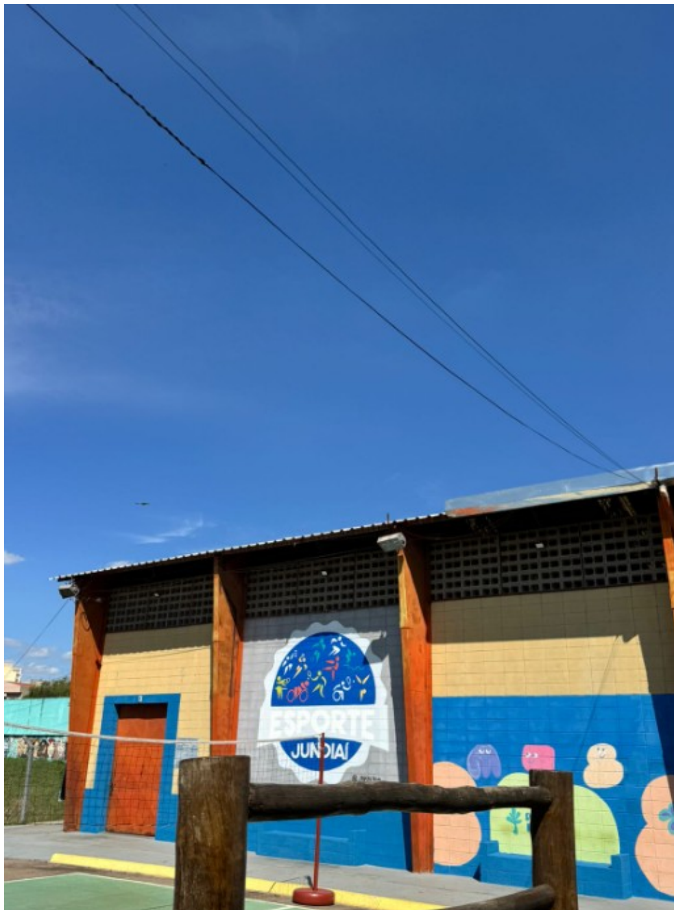
ANEXO 1 Foto mostra o espaço sem a calha no ginásio
