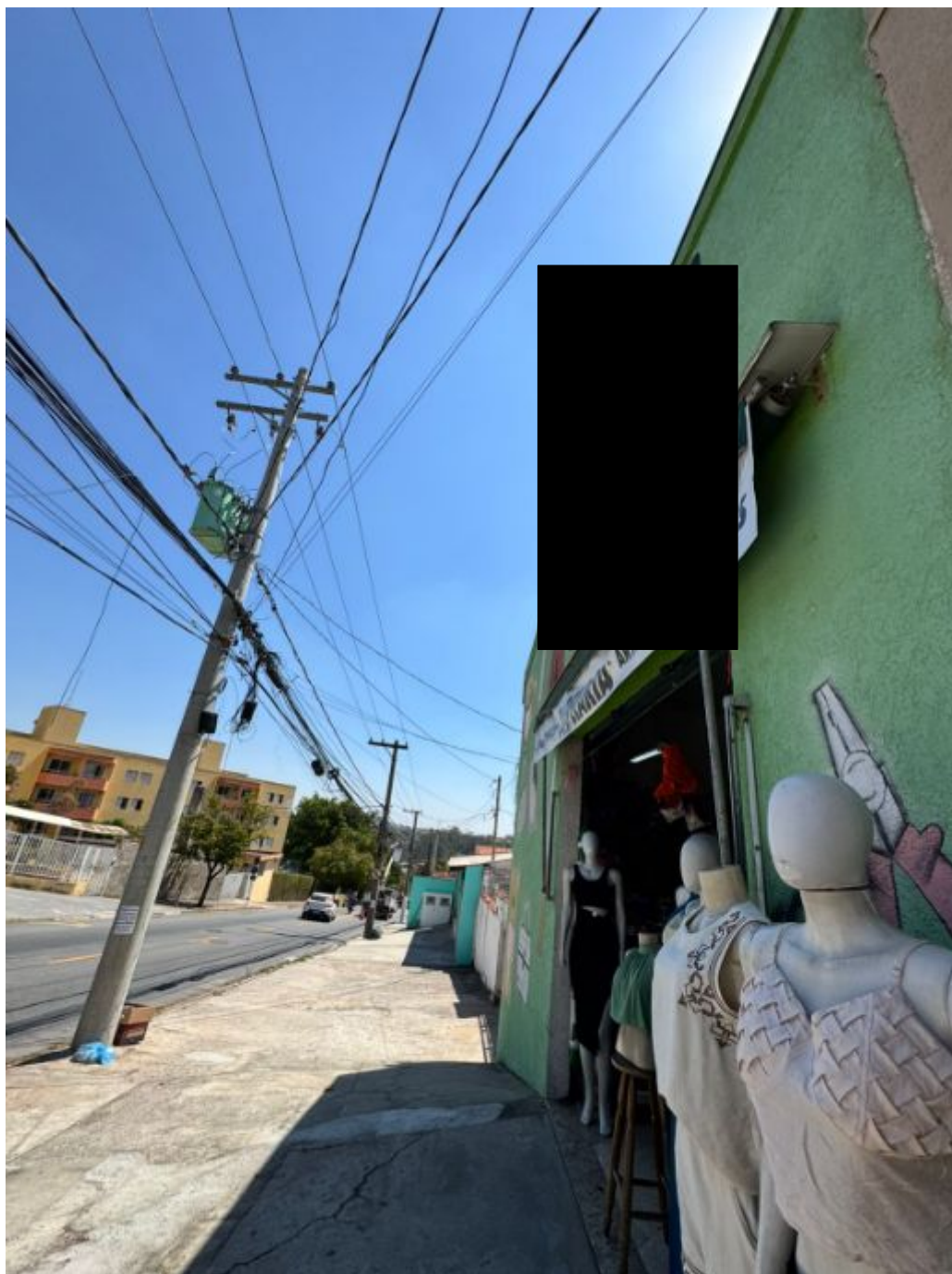
Postes que estão sem braços de iluminação
