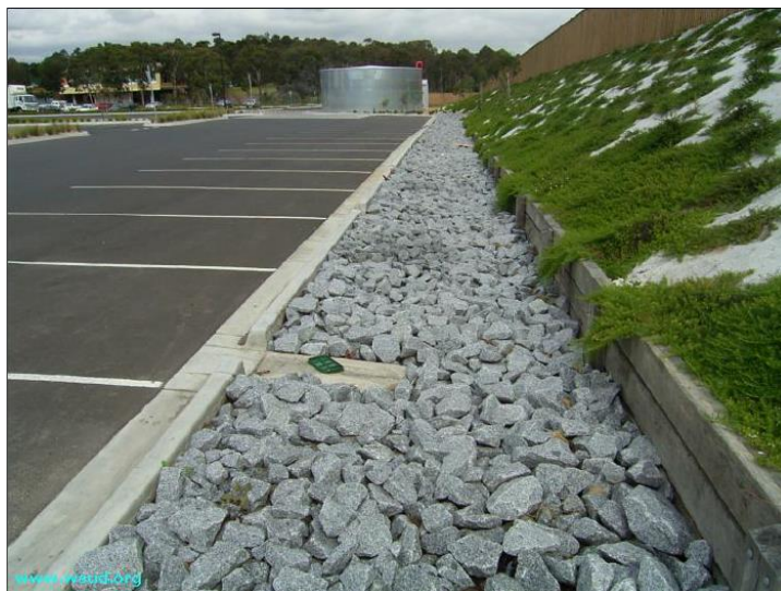
Figura 7.15 – Trincheira de infiltração
