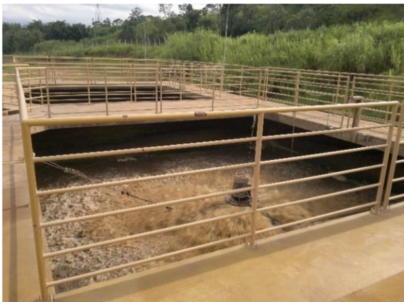
Figura 4.18 - Tanques de aeração da ETE Fernandes
