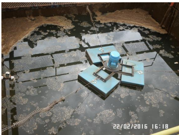
Figura 4.19 - Tanques de aeração da ETE Fernandes
