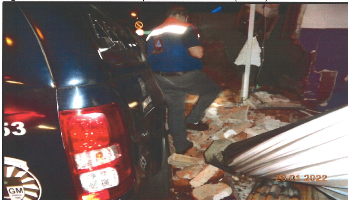
Figura 7 – Estrutura Danificada após colisão de veículo (Centro)
