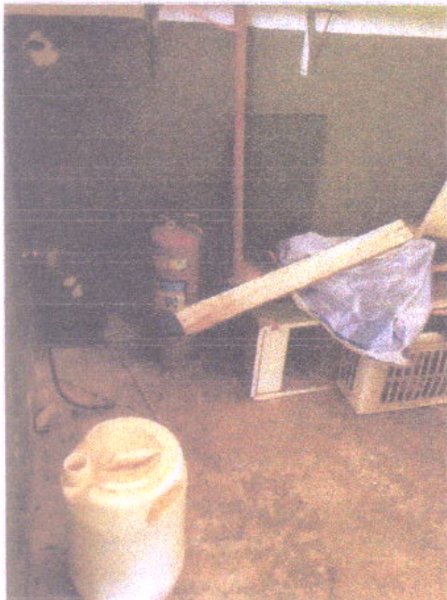
EXTINTOS E EQUIPAMENTOS ARMAZENADOS EM LOCAL INADEQUADO
