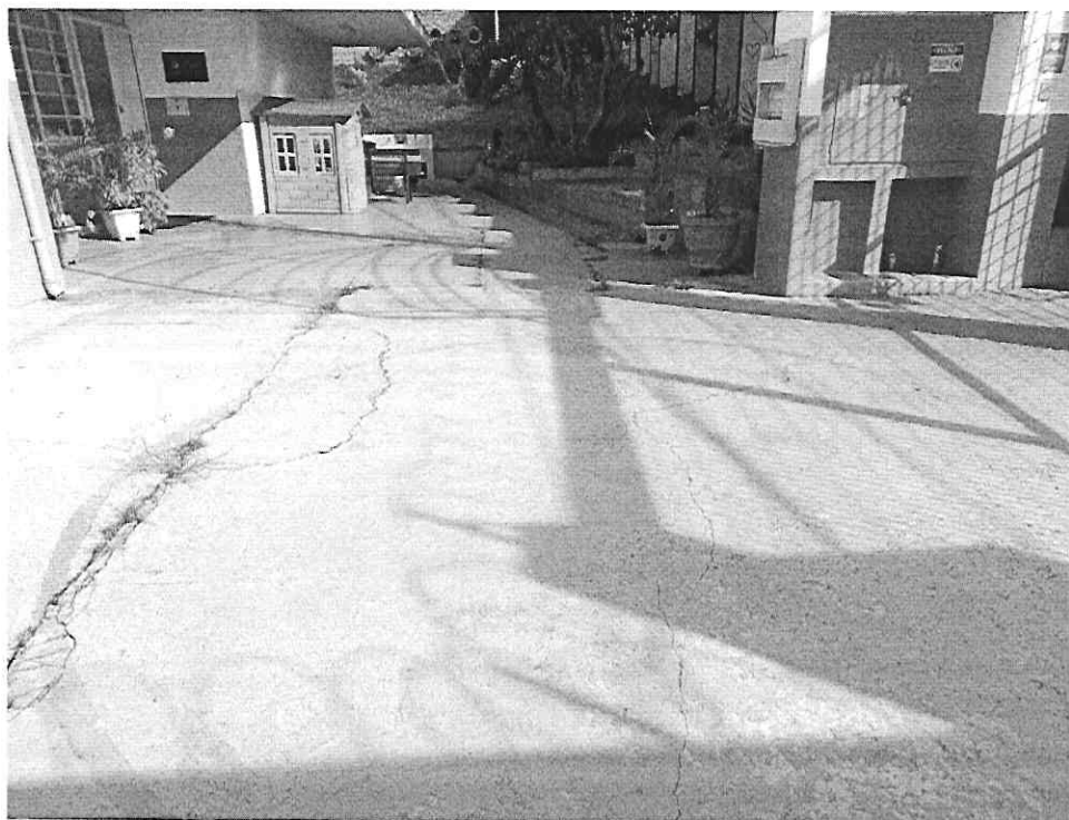
PISO DA ENTRADA NECESSITA DE MANUTENÇÃO
