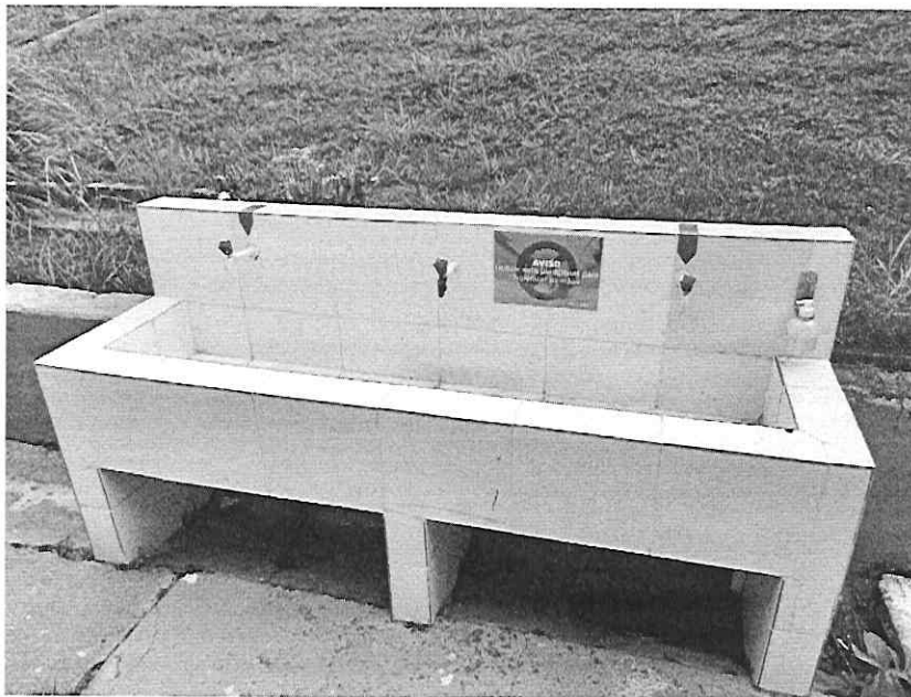
FALTAM FILTROS NOS BEBEDOUROS
