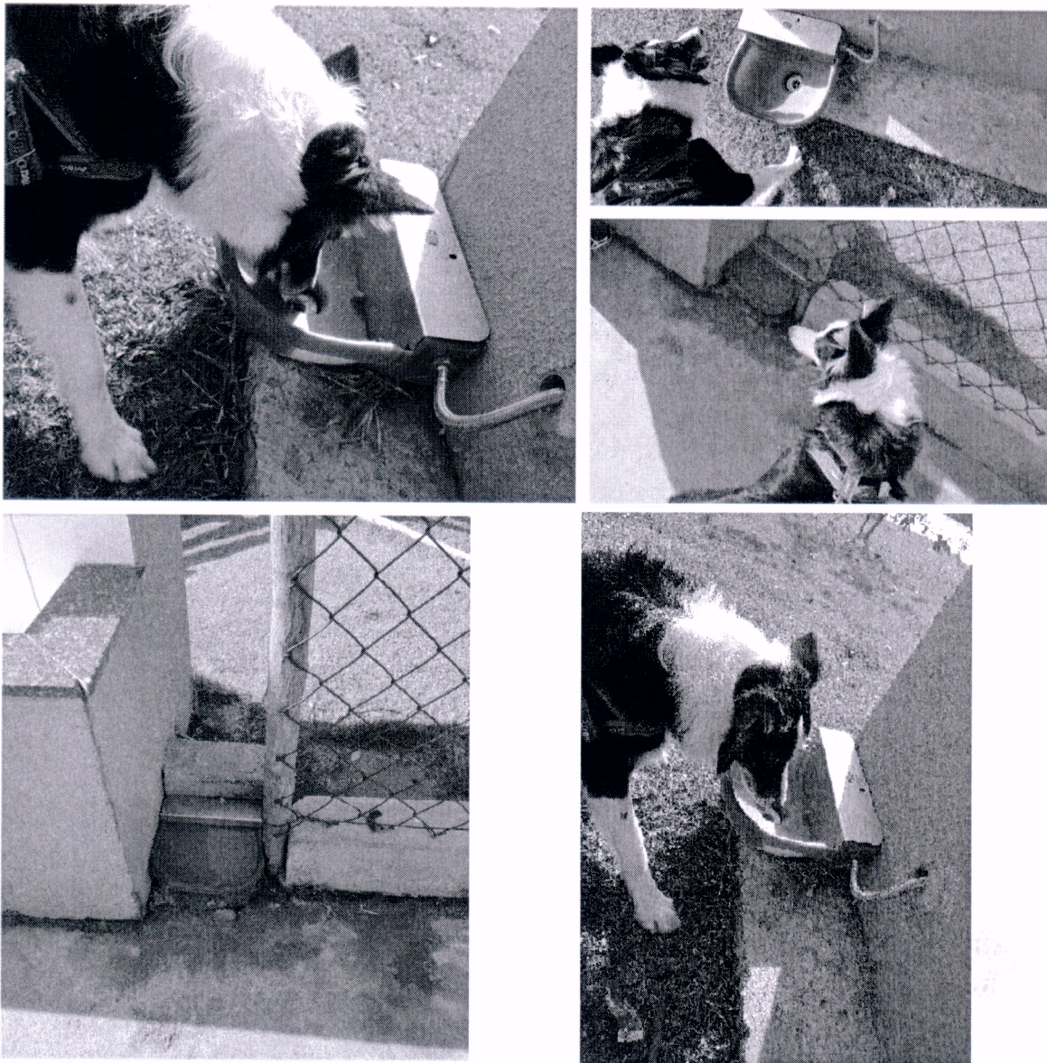
Registros fotográficos, evidenciando mau funcionamento dos bebedouros automáticos instalados no Parque "Angelo Costa" (Engordadouro).
