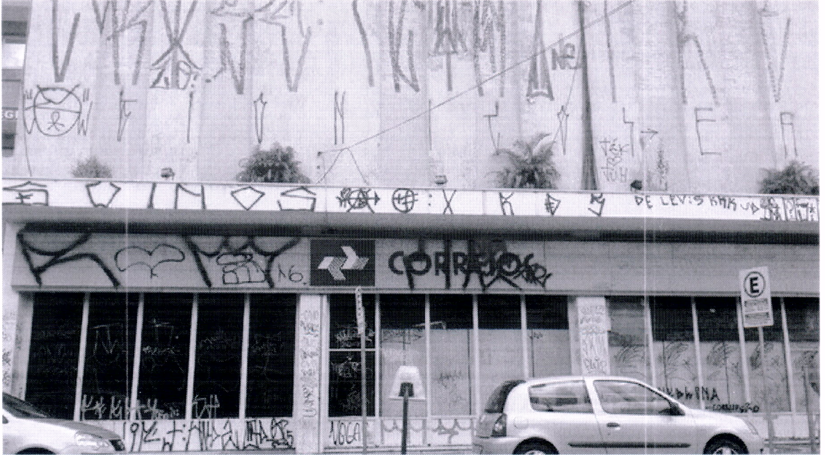
Agência Central dos Correios, à rua Marechal Deodoro da Fonseca, com aspecto horrível causado pela pichação
