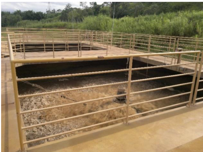
Figura 4.18 - Tanques de aeração da ETE Fernandes
