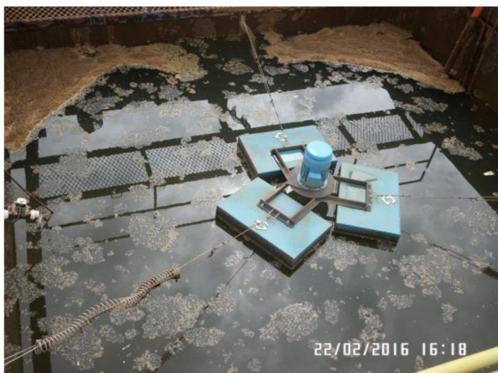
Figura 4.19 - Tanques de aeração da ETE Fernandes
