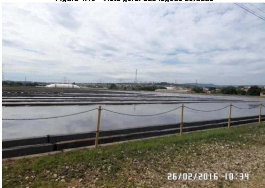
Figura 4.15 - Vista geral das lagoas aeradas
